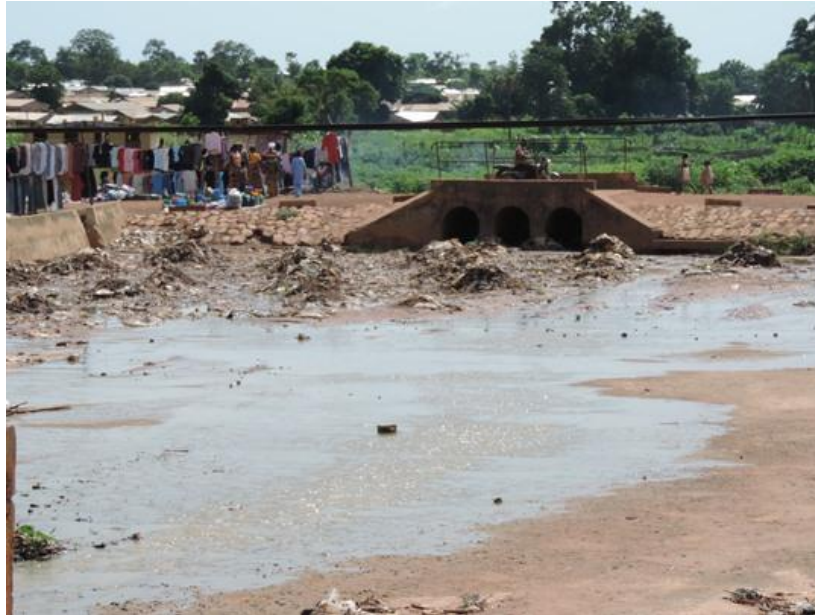
Photo 6 : Etat du collecteur principal de la ville près du marché central
