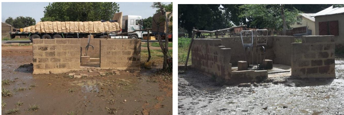
Photo 8 : Etat des abords de points d'eau potable à Kandi
