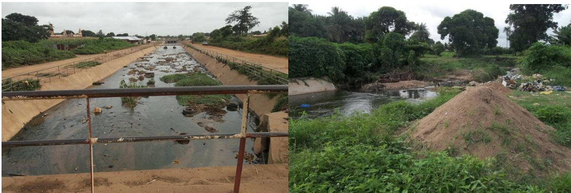
Photo 1 : Etat d'un collecteur mal entretenu et de son point de chute à Parakou
