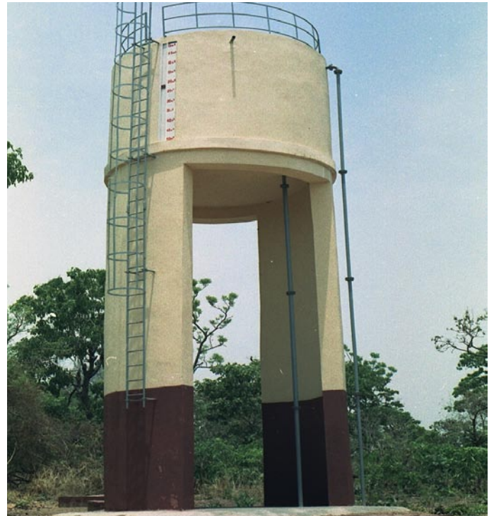
Un château d'eau réalisé à Gamia dans le Borgou
