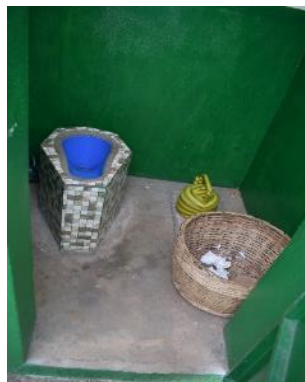
Bloc sanitaire public équipé de pots à Satopan réalisé et mis en service au niveau du poste de péage de Ahouicodji avec l'appui du Projet AEPHA exécuté par Oxfam-Novib (Commune de Ouidah).
