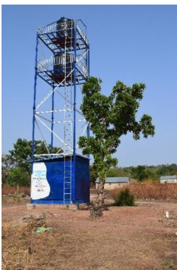
PEA solaire réalisé et mis en service à Ouèssèné avec l'appui du Projet AEPHA exécuté par Helvetas à Gogounou et alimentant plusieurs borne fontaines.
