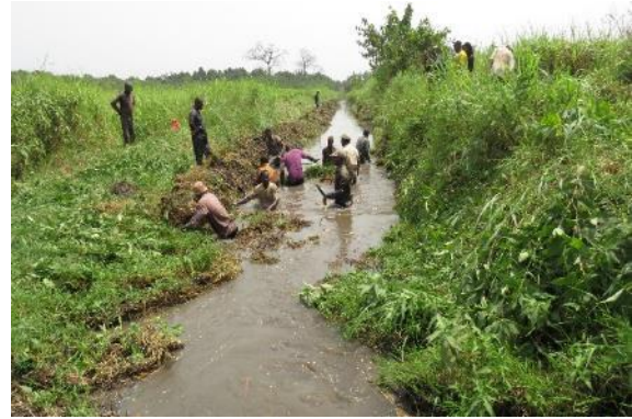
Travaux de désencombrement d'un canal exutoire selon une technique endogène identifiée par le projet PSL Eau dans le village de Sèdjè-Dénou (Commune de Zè).
